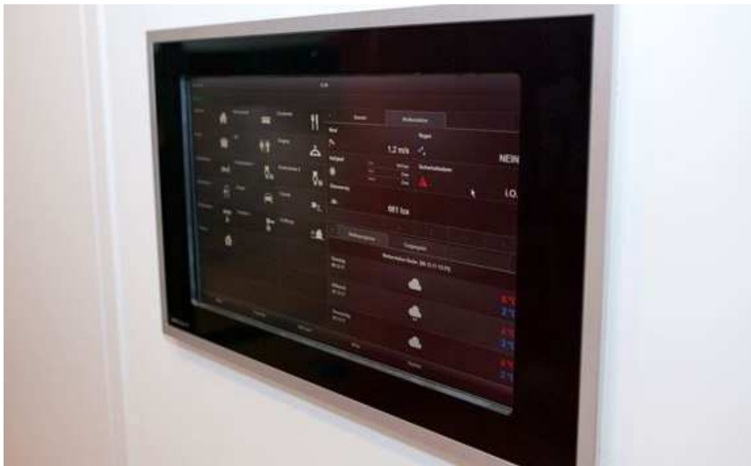
Touchpanel zur Steuerung der Haustechnik
